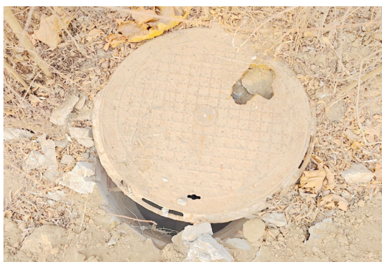
项目内市政上水预留口
